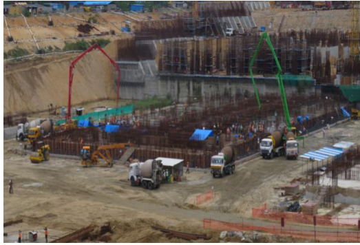
Figure 1(a). Mega pour @location 1
